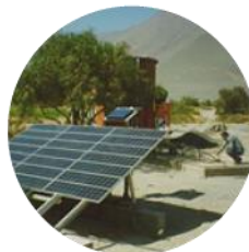
Bombeo de agua
