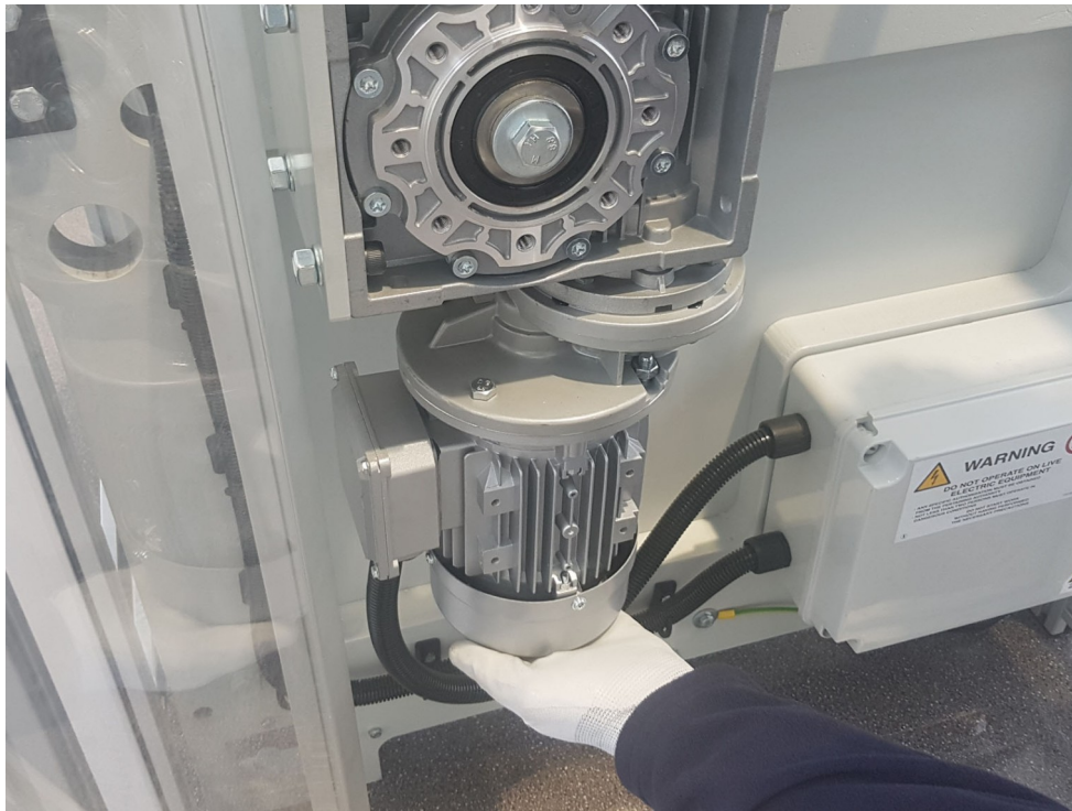
Figura 6.2.6 – Pulizia delle ventole dei motori
