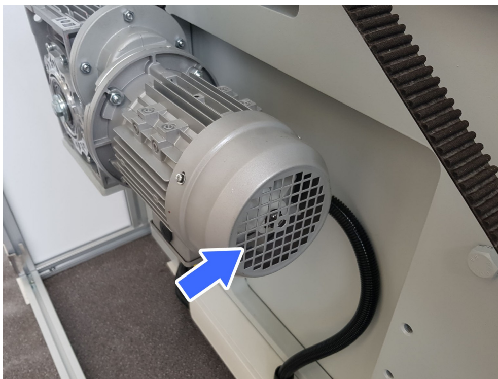
Figura 6.2.8 – Pulizia delle ventole dei motori
