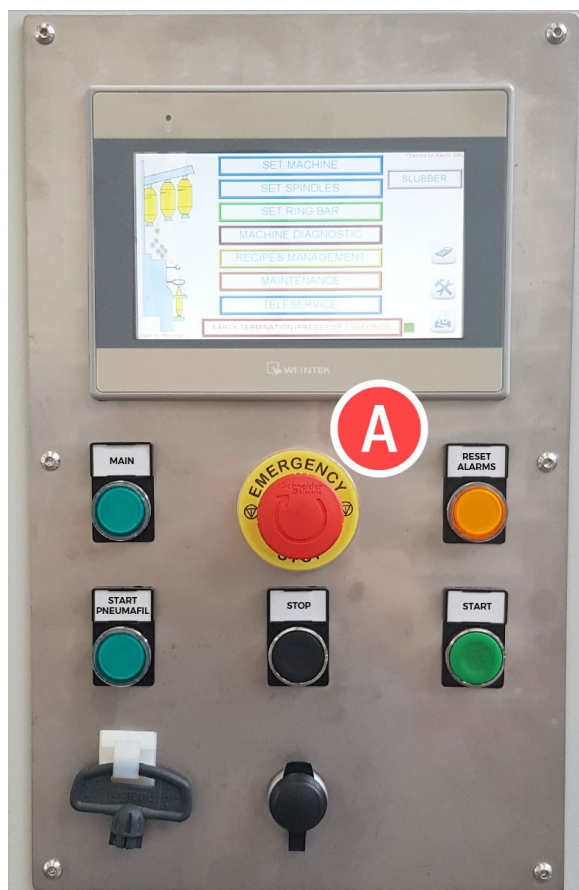
Figura 5.2.1 – Pannello di controllo
