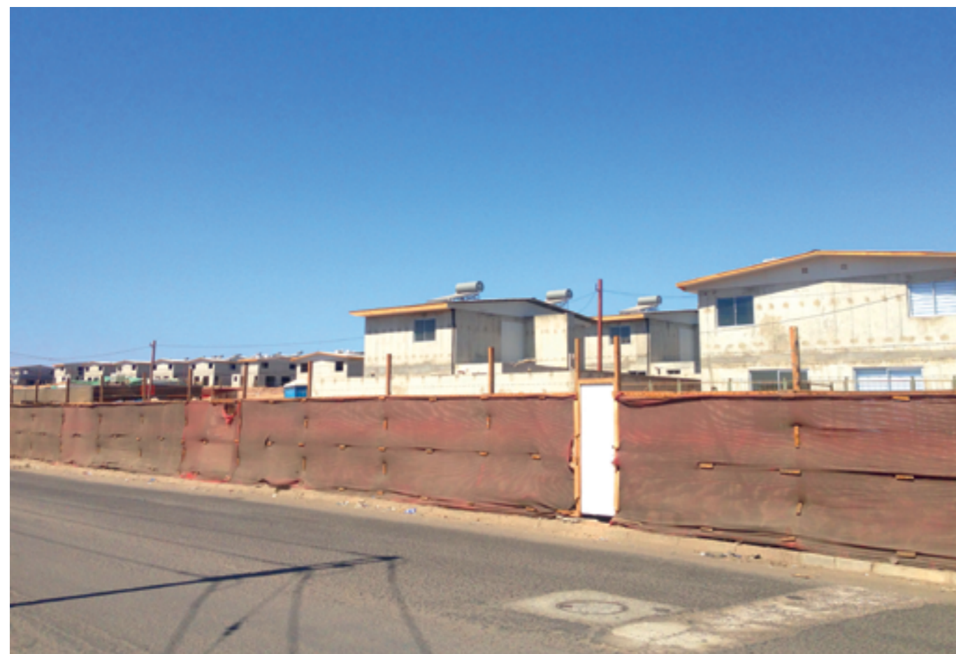
LAS FAMILIAS DE LA POBLACIÓN GUAÑACAGUA III VIVIERON DURANTE 17 AÑOS EN LAS LLAMADAS "CASAS QUEBRADAS", DEBIDO A LOS DAÑOS ESTRUCTURALES OCASIONADOS POR EL SUELO SALINO. EL CONJUNTO HABITACIONAL CONSTRUIDO PARA SU REINSTALACIÓN CUENTA CON UN COMPLETO SISTEMA DE COLECTORES SOLARES PARA AGUA CALIENTE SANITARIA.
