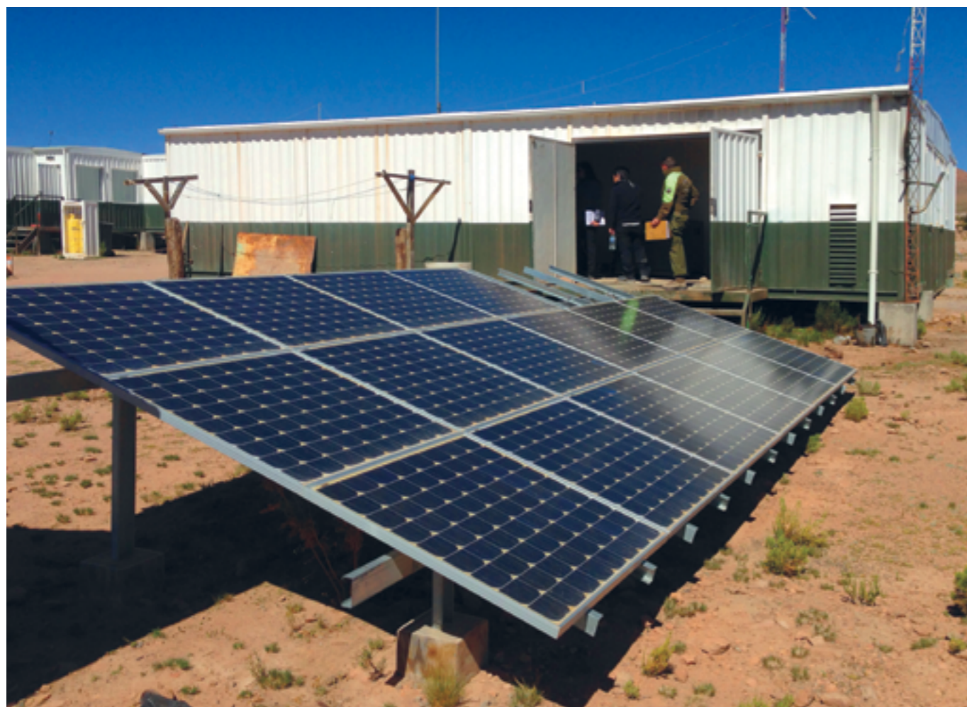
PLANTA FOTOVOLTAICA EN RETÉN DE CARABINEROS DE CORONEL ALCÉRRECA, LOCALIDAD FRONTERIZA EN LA COMUNA DE GENERAL LAGOS.
