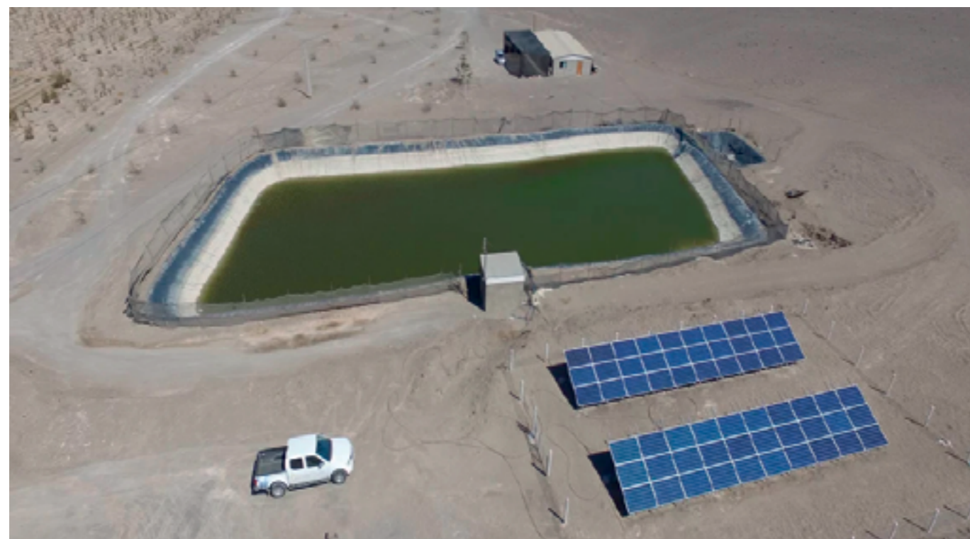
SISTEMA DE BOMBEO SOLAR LOS LAGOS: 60 PANELES Y 15 KW DE POTENCIA ENTREGAN ENERGÍA PARA REGAR 36 HECTÁREAS DE TERRENO CULTIVABLE EN LOS CERROS DEL VALLE DE AZAPA.
